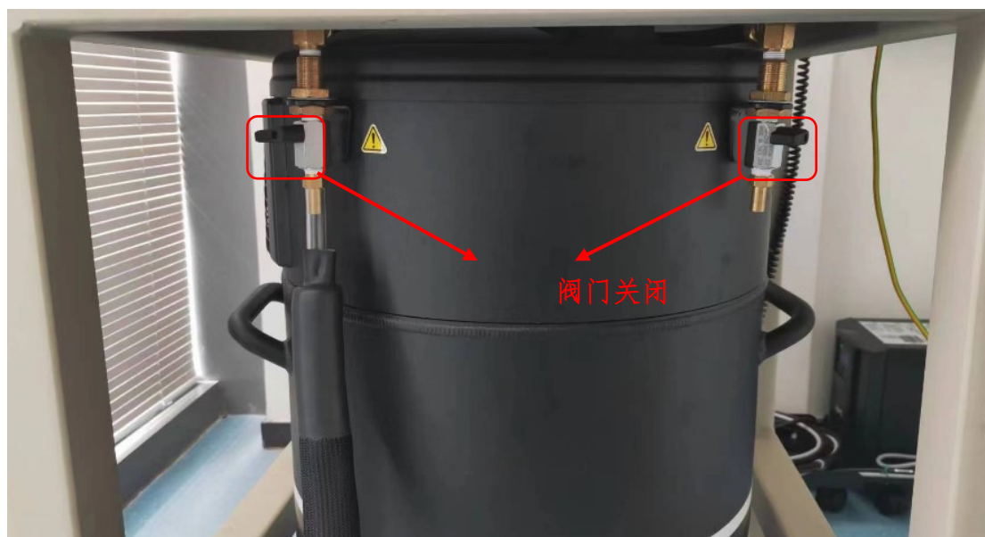
图 15 液氮回凝制冷器阀门关闭
